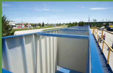
Vue intérieure du réservoir à séparation « Weir Tank »
